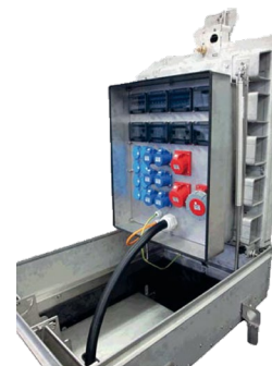
System gniazd i zabezpieczeń wraz z ochronnym dzwonem nurkowym
